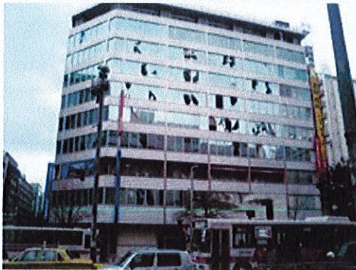
地震により窓ガラスが割れて破損したビル(福岡市)
