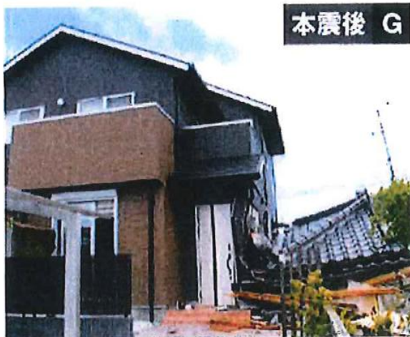
本震後のG。Hの住宅が倒壊した影響で外壁の一部が損傷した。外観からはそのほかの被害は確認できなかった (写真：日経ホームビルダー)
