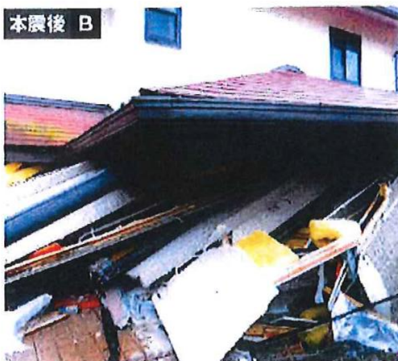
本震で1階が崩壊したプレハブ住宅（写真：日経ホームビルダー）
