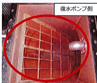
4A-復水ポンプ入ロストレーナ
