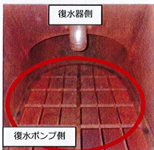
3 A-復水ポンプ入ロストレーナ
