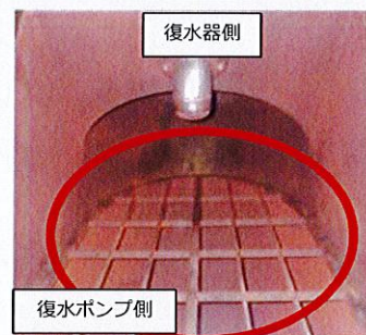
3 C-復水ポンプ入ロストレーナ
