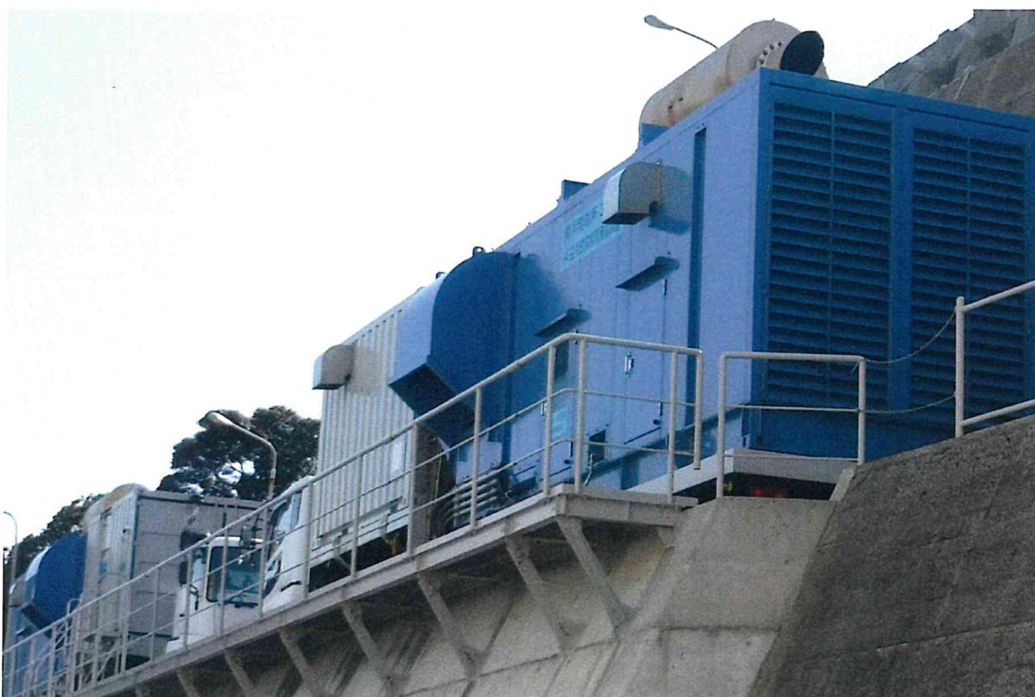
【図表 4 0 空冷式非常用発電装置】
