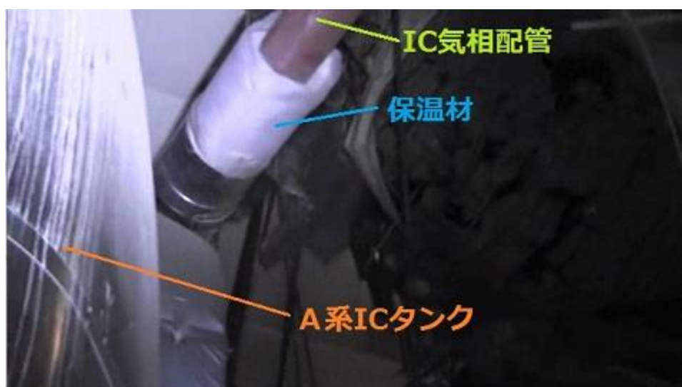
写真 1 1 : 非常用復水器北側の保温材脱落状況 (甲 3 2 6)
