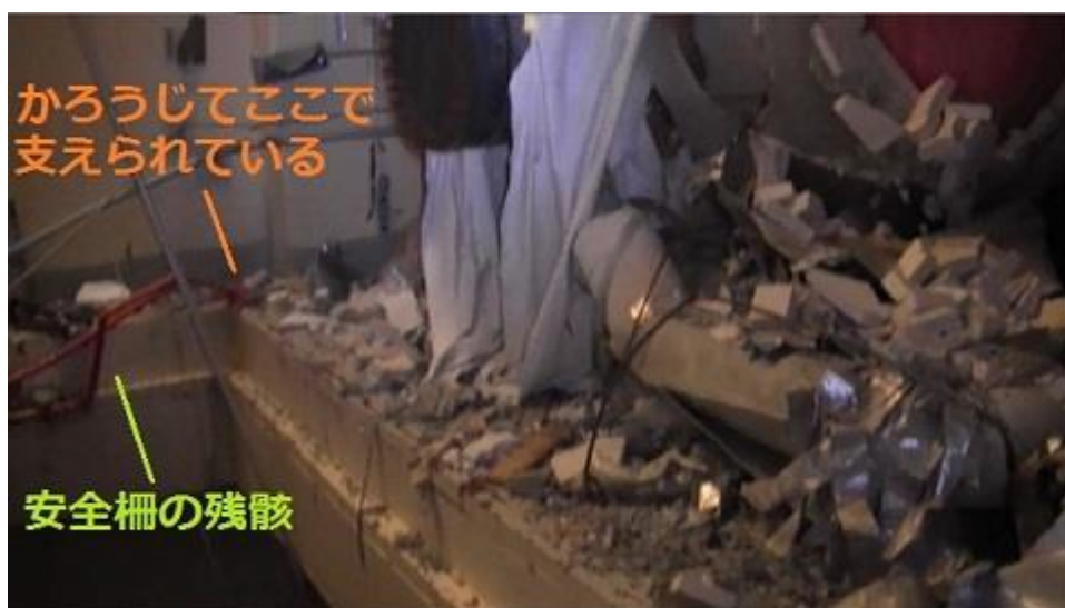
写真4：4階大物搬入口北側安全柵が失われた状況（甲326）
