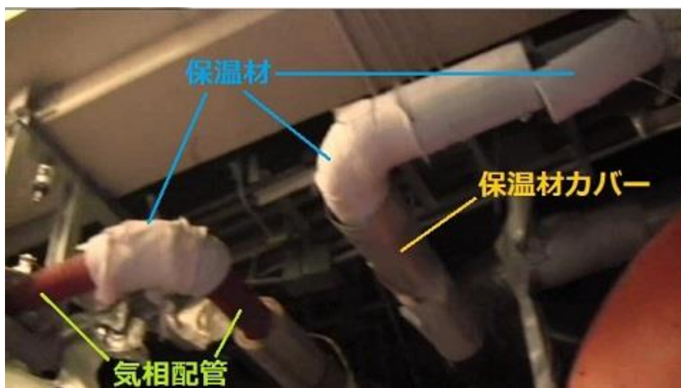
写真2：非常用復水器南側気相配管の保温材脱落状況（甲326）
