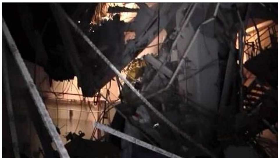
写真 9：原子炉建屋 4 階北側天井の破損開口部の状況（甲 3 2 6）
