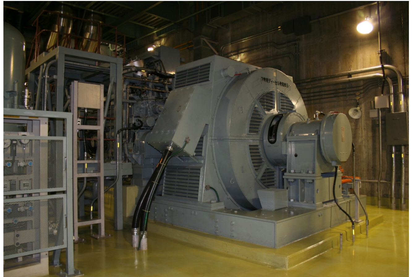
非常用ディーゼル発電機（浜岡原発4号炉）
